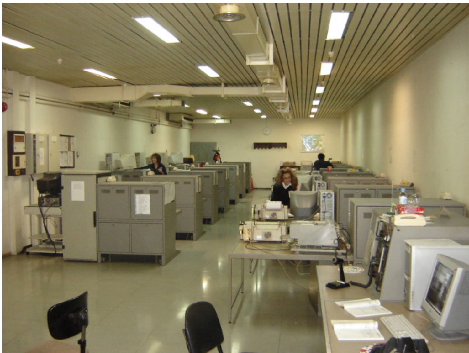
69. Στρατιωτική Διοίκηση Ανατολικής Μεσογείου (ΣΔΑΜ) στον Άγιο Γιάννη τον Κυνηγό 88 (Αγία Παρασκευή) 70. ΣΔΑΜ, οι υπόγειοι χώροι του Επικοινωνιακού Κέντρου (πηγή: ιστοσελίδα της ΣΔΑΜ) 89
