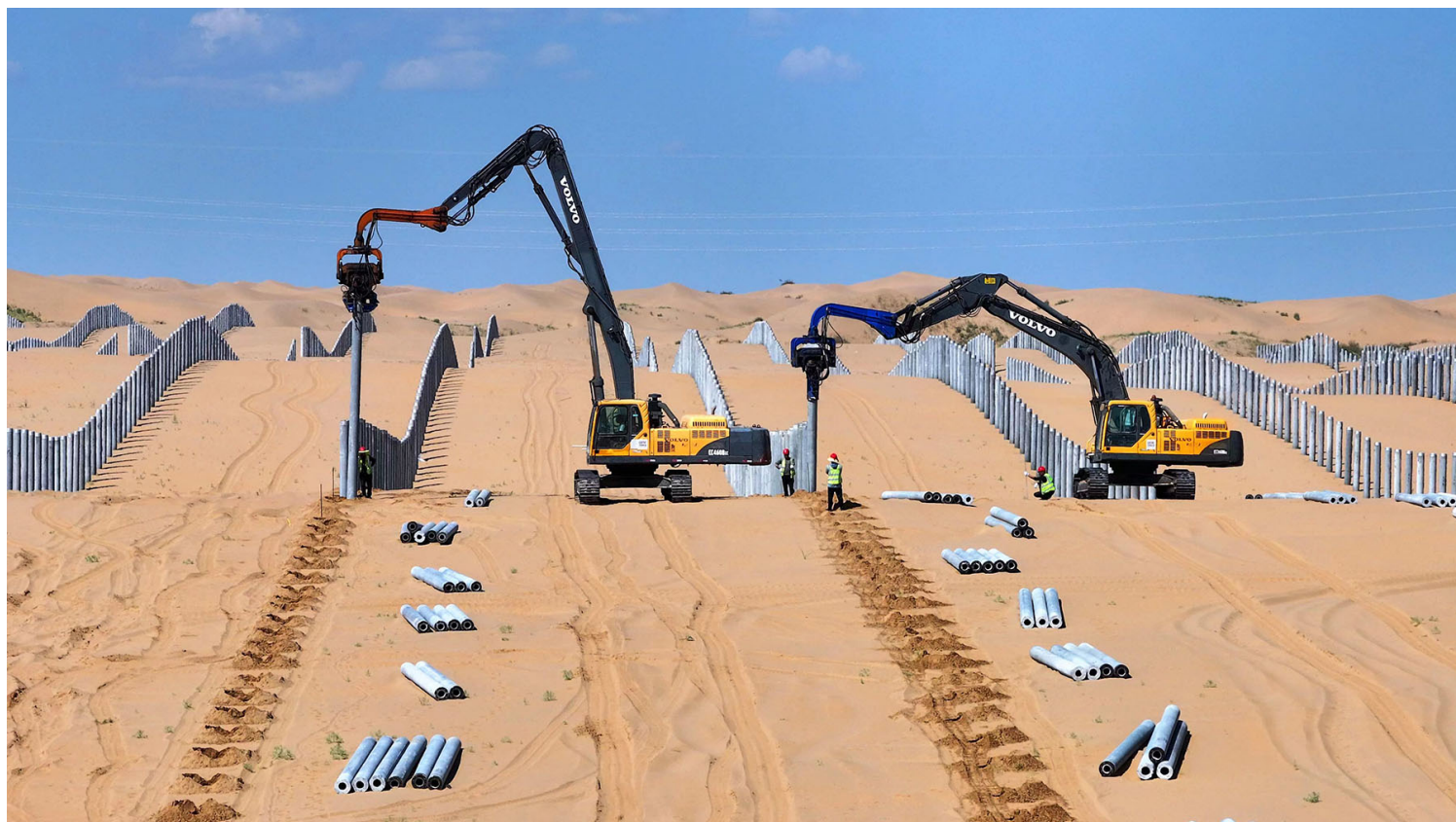
Great Wall, Φωτοβολταϊκή Εγκατάσταση, έρημος Kubuqi, Κίνα
