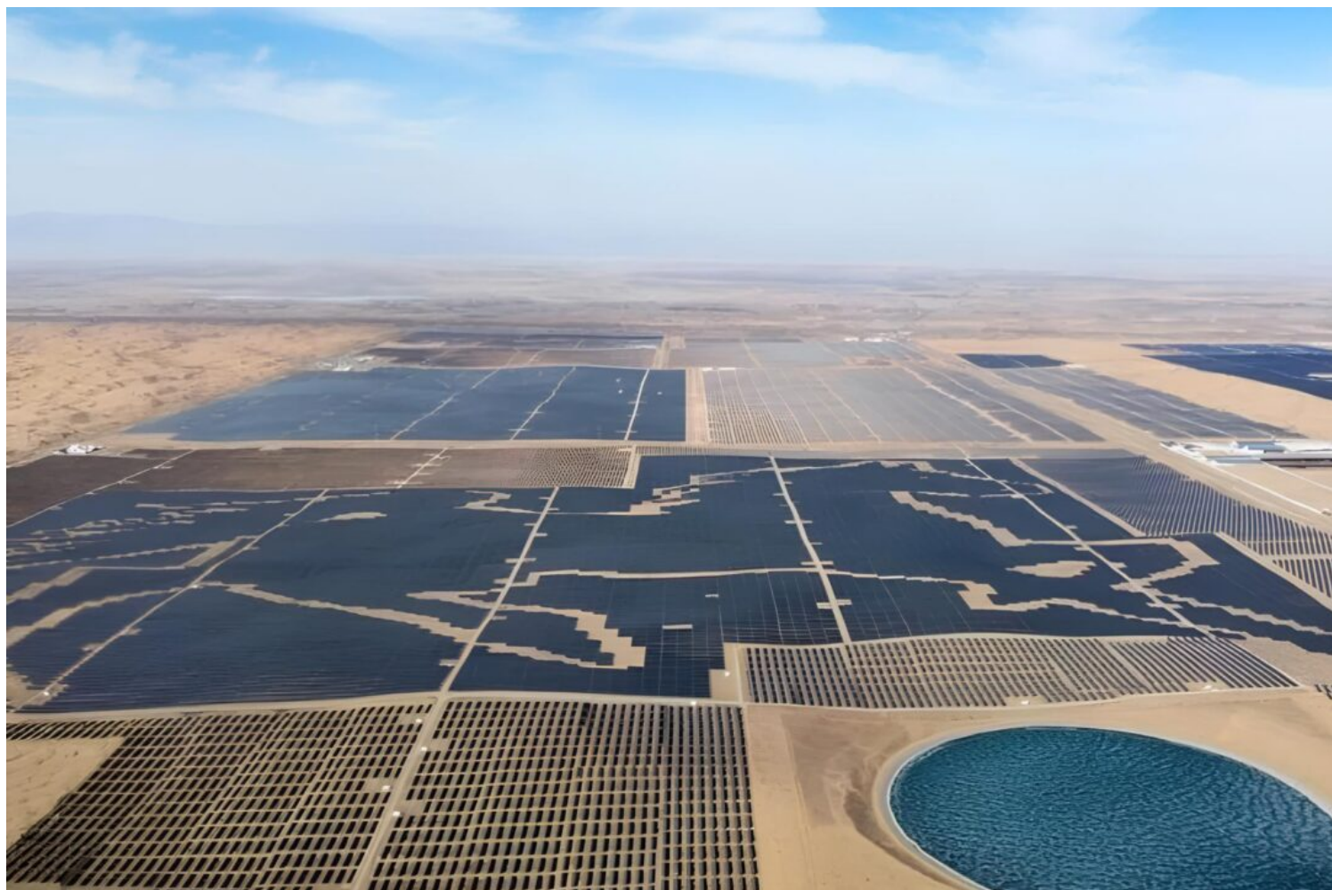
Great Wall, Φωτοβολταϊκή Εγκατάσταση, έρημος Kubuqi, Κίνα
