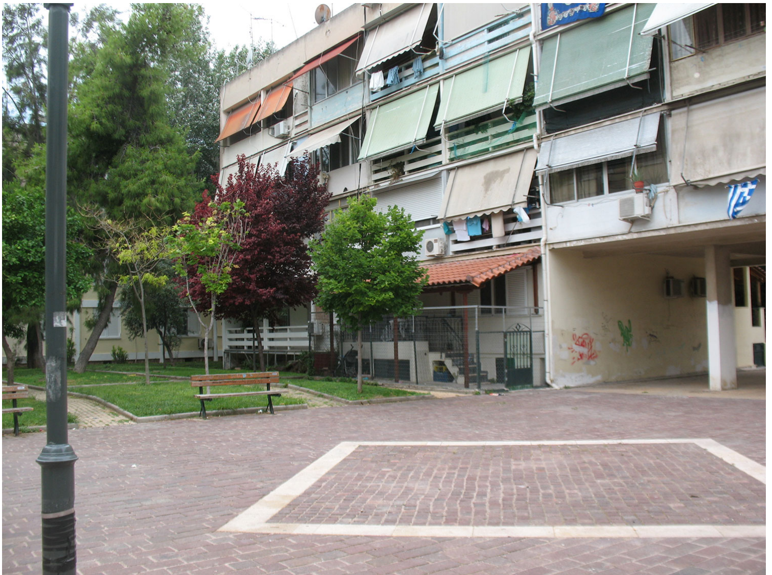
Ταύρος, 1960. Δειλή κατάληψη του κοινόχρηστου χώρου με σκάλα και μικρή περίφραξη, πολλοί εξώστες όμως είναι ήδη διαμορφωμένοι ως επέκταση δωματίων.
