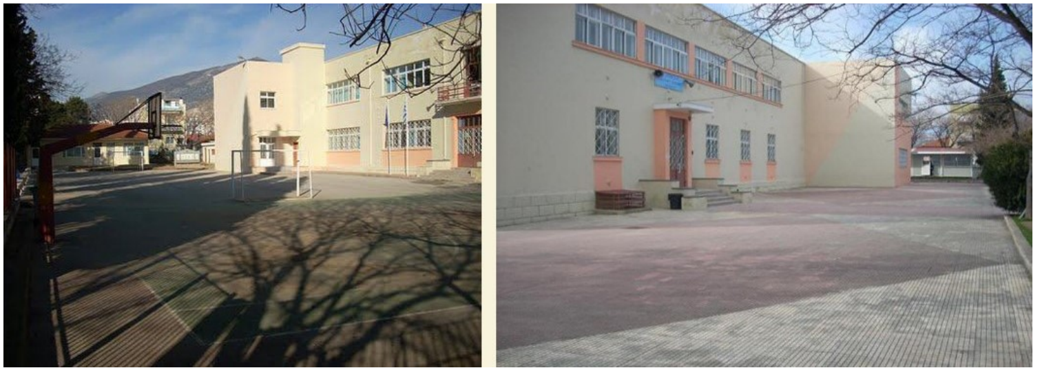
Εικόνα 6. Το Δεύτερο Δημοτικό Σχολείο της Εάνθης (Καραντινός). Διακρίνονται η προσθήκη πτέρυγας και οι τροποποιήσεις των ανοιγμάτων στις όψεις. Πηγή εικόνων: Σύλλογος απόφοιτων 2ου Δημοτικού Σχολείου Εάνθης, πρόσβαση Ιανουάριος 21, 2021, http://sillogos-apofiton-2odimotikoxanthis.blogspot.com/ .
