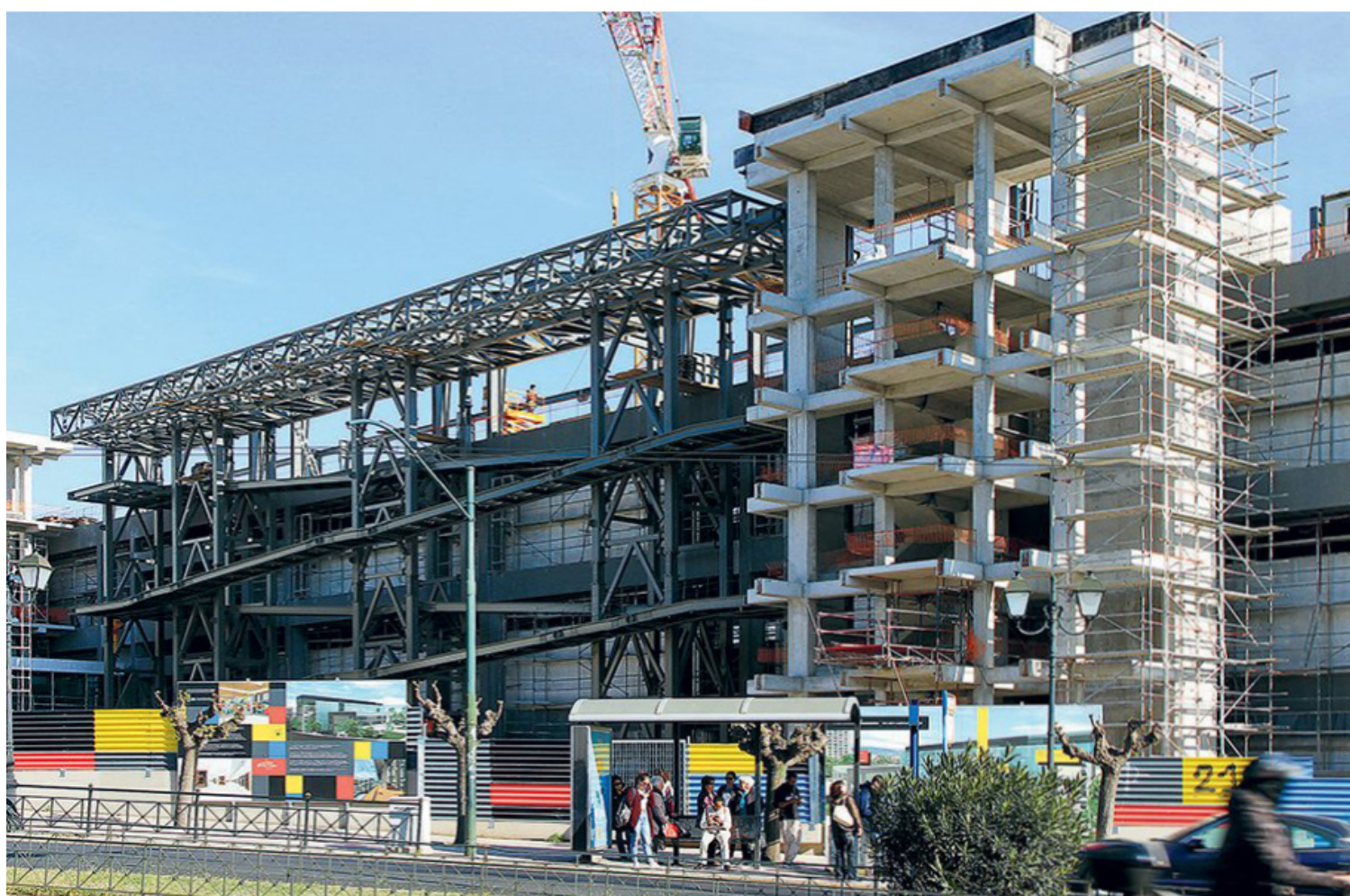
Εικ. 29. Πίσω από το υαλοστάσιο οι, πέρα από κάθε λογική και μέτρο, θηριώδεις φέρουσες κατασκευές των κλιμακοστασίων και των ραμπών, που -σαν οχρωματικό έργο- ήρθαν κι ακούμπησαν βίαια πάνω στην αόρατη, πλέον, μοντερνιστική όψη. [Πηγές: Άνω: φωτ. Γιώργος Τριανταφύλλου. Κάτω: https://www.kathimerini.gr/life/city/1024987/ethniki-pinakothiki-katagelloyn-parapoiisi/ ]
